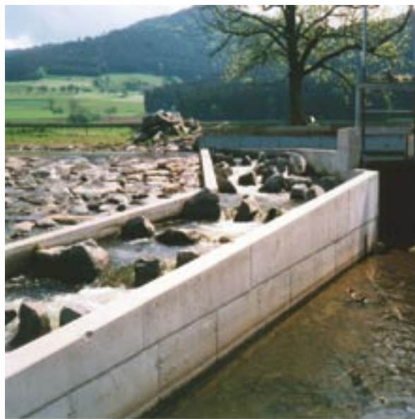
Abb. 80, Fischaufstieg an einer modernen Wasserkraftanlage
