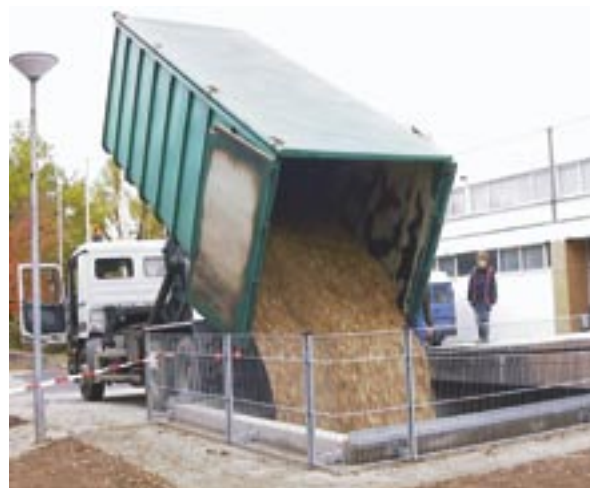
Abb. 89, Befüllen des Silos mit Holz-Hackschnitzeln
